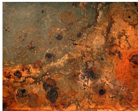
La rouille, résultat de la corrosion sur du fer.
